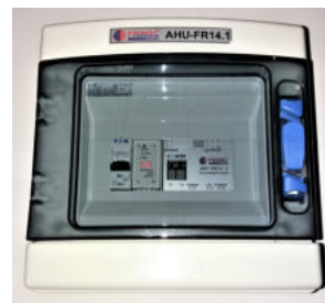
Komunikační box AHU-FR19.1
