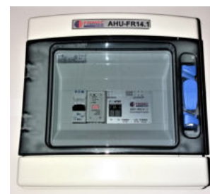
Komunikační box AHU-FR14.1
